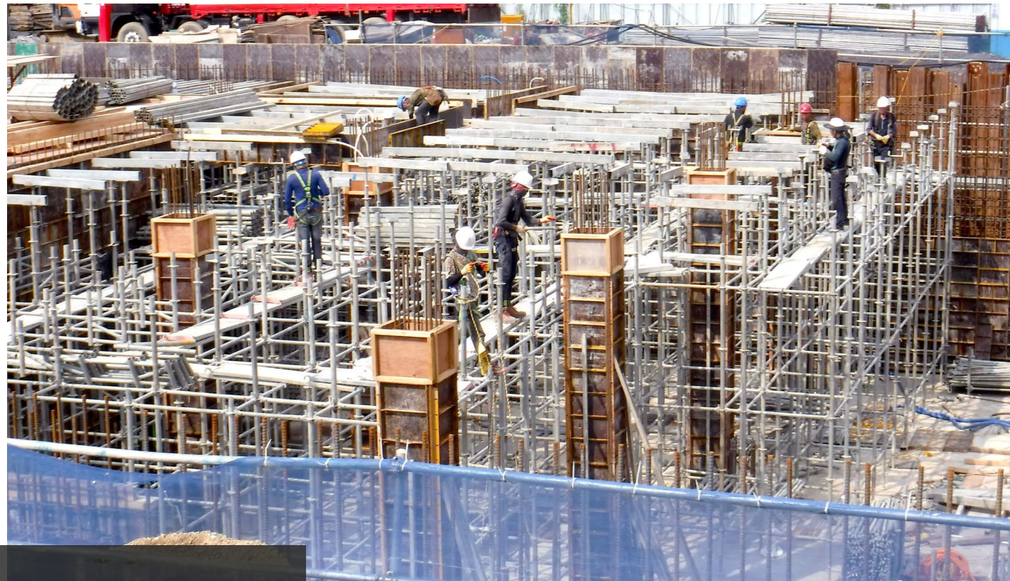
화성 봉담 공공하수 처리시설 증설사업 원도급사 : 에이스개발 공사위치 : 경기도 화성시 봉담읍 공사규모 : 지하2층, 지상층
